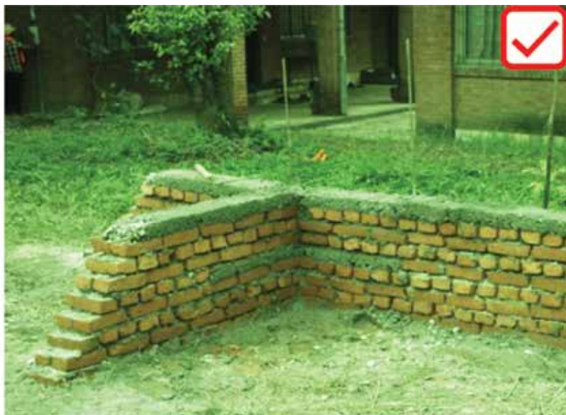
पछि जोडेर निर्माण गर्नका लागि छोडिएको खुडकिला
