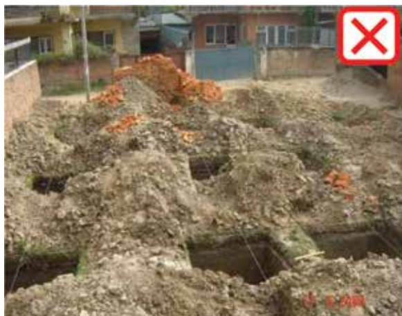
खनिएको माटो निर्माण स्थलबाट हटाइएको छैन ।
